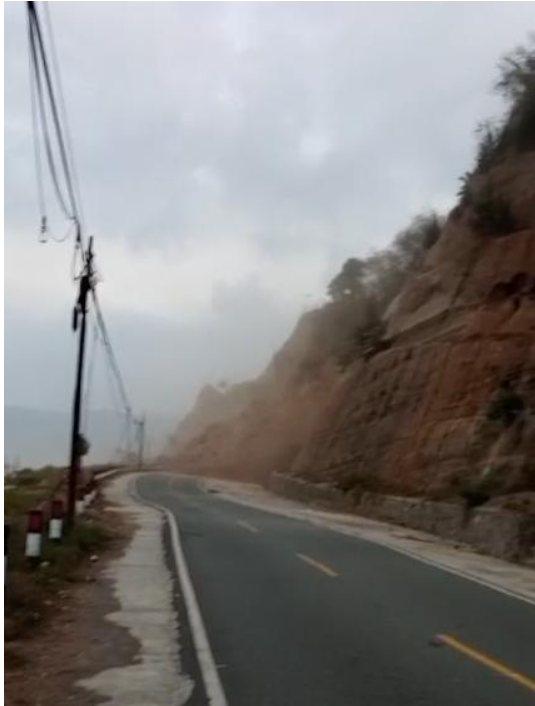
Gambar 3. Longsor di Jalan Trans Ende-Bajawa
